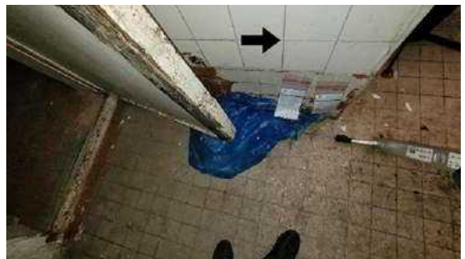
Plonge : PA18 Joint Faïence Amiante
