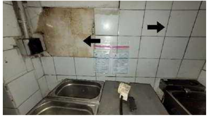
Cuisine 01 : PA12/13 Colle et Joint Faïence Amiante
